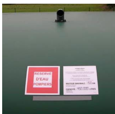
Trop plein et signalisation sur la réserve d'eau (destination et capacité)
