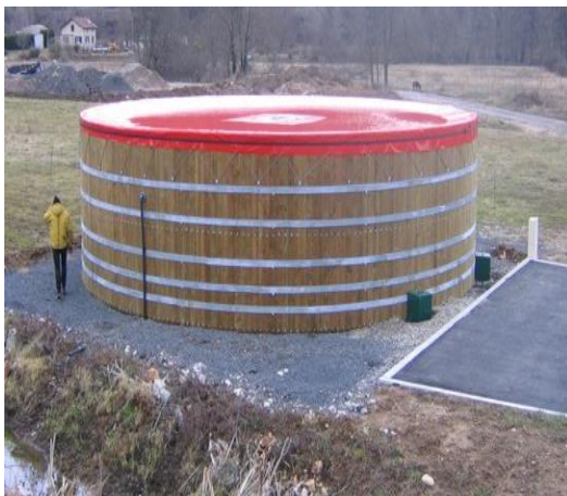
Réserve d'eau incendie aérienne équipée de 2 sorties de 100 mm
