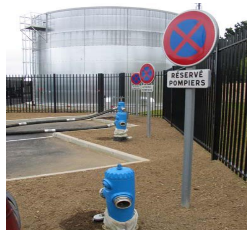
Réserve d'eau incendie aérienne de 720 m 3 équipée de 3 poteaux d'aspiration de 150 mm
