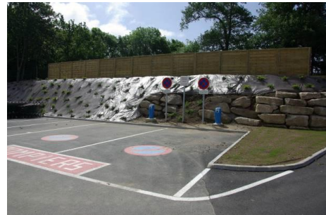
2 Plates formes d'aspiration sur une réserve d'eau équipée de deux poteaux d'aspiration de 100 mm
