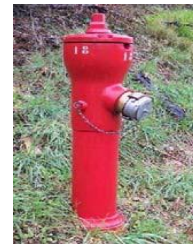
Poteau incendie de 80mm avec une sortie de 65mm
