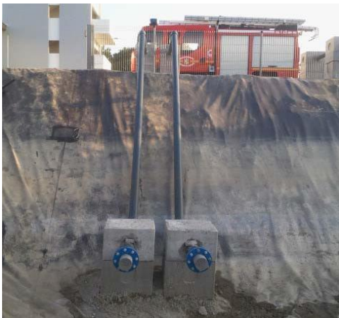
Deux colonnes de 100 mm sur une réserve d'eau ouverte
