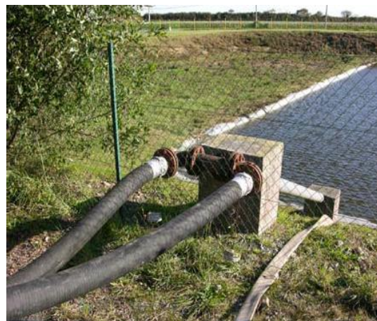
Réserve d'eau ouverte avec 1 colonne de 150 mm alimentant 2 sorties de 100 mm
