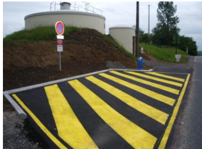
Plate forme d'aspiration sur une réserve d'eau équipée d'un poteau d'aspiration de 100 mm
