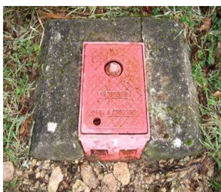
Bouche de lavage fermée
