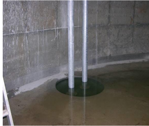
Fond de la cuve avec crépine sous le niveau le plus bas de l'eau
