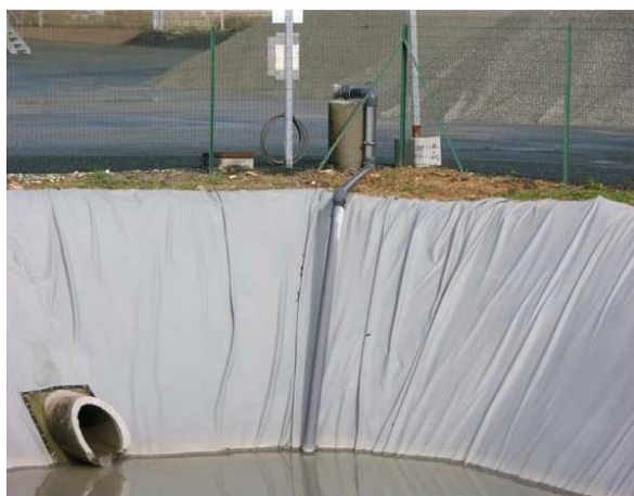
Réserve d'eau ouverte avec film PVC et une colonne d'aspiration de 100 mm
